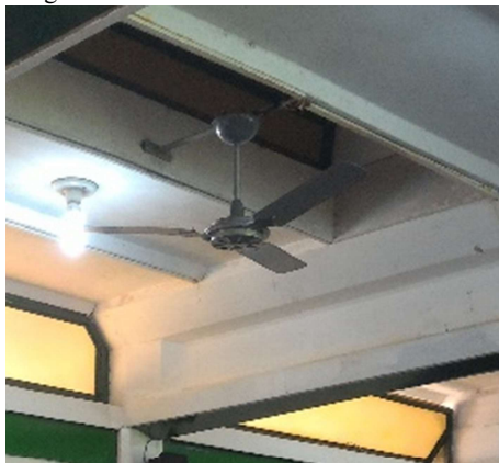
Figura 9 - Ventiladores das salas analisadas.
