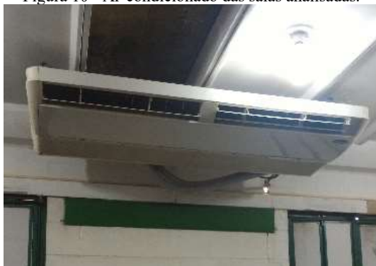
Figura 10 - Ar-condicionado das salas analisadas.
