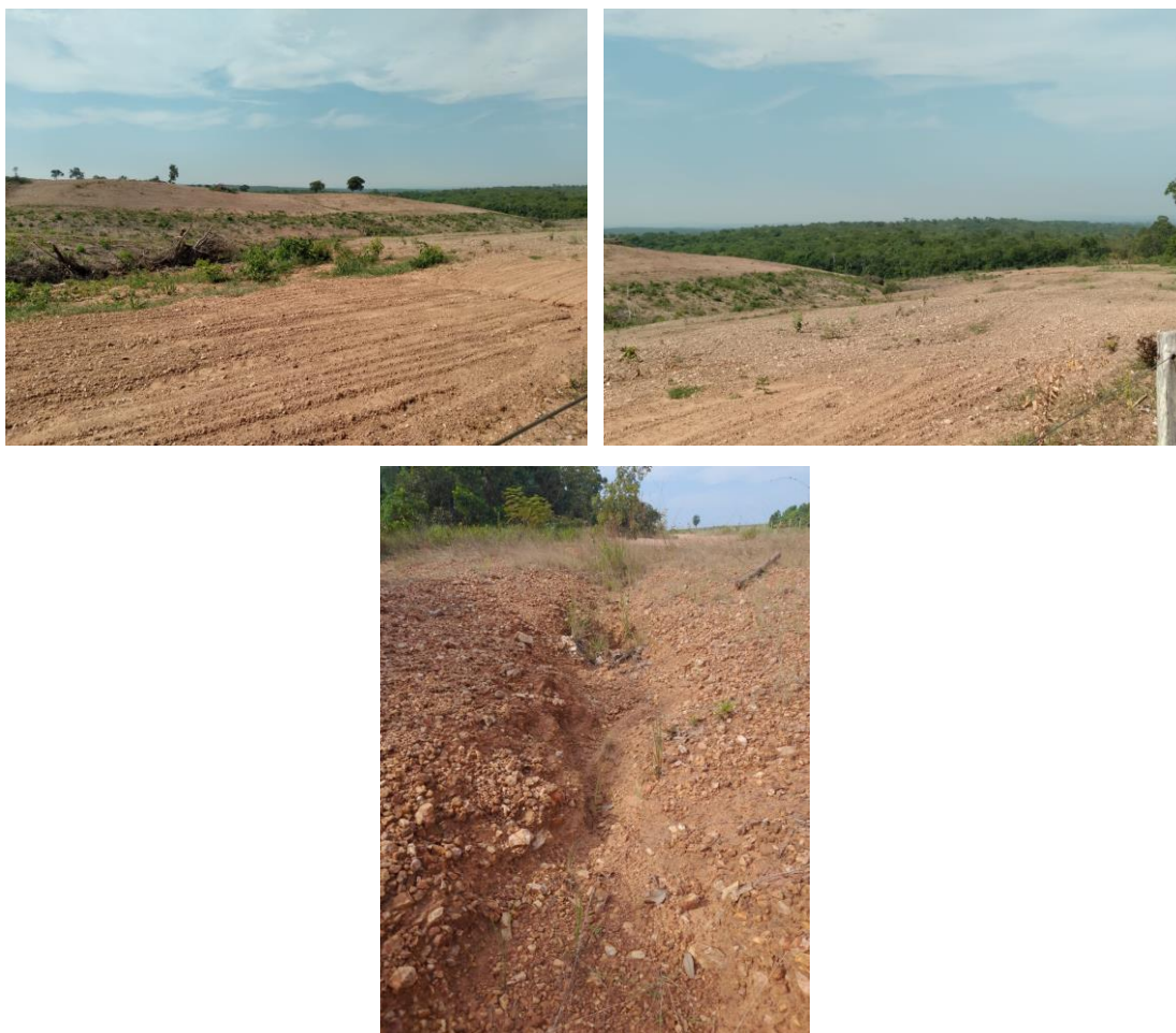
Figura 27: Área com início de feições erosivas ocasionadas pela remoção de vegetação
